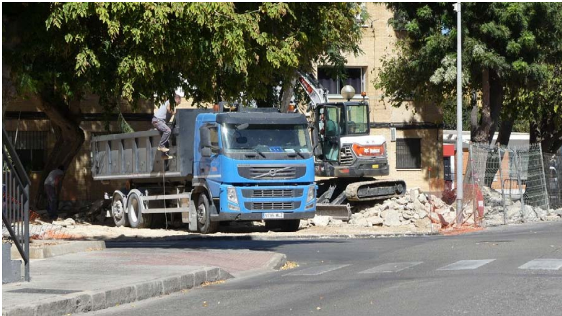
Zona de la obra en la que se ha producido la incidencia
