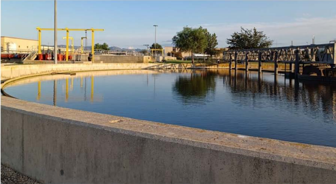
La estación depuradora de Alzira.
